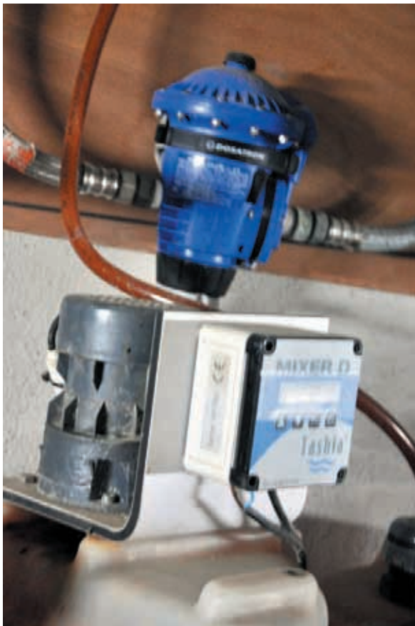
Cuentan con Tashia y el sistema de Dosatron para mantener el agua en buenas condiciones.
