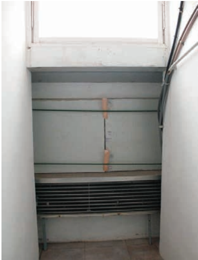
La entrada de aire se calienta con radiadores de agua
