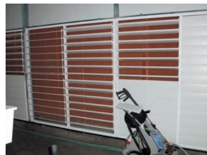
El panel de celulosa se encuentra protegido por deflectores de plástico.
