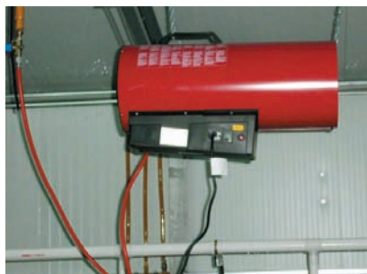
La calefacción en la nueva instalación se realiza mediante calefactores de gas.
