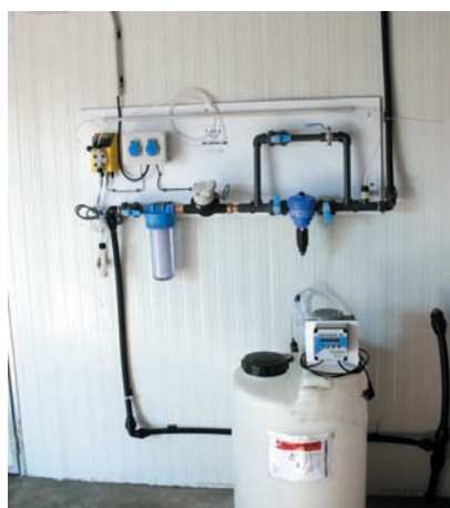
El control del agua automático es una pieza básica en la nueva instalación.
