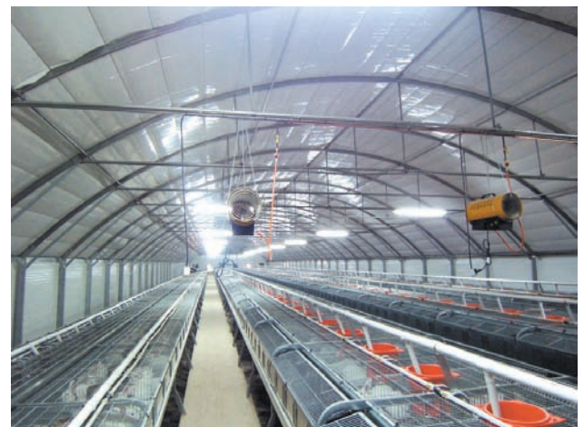
Detalle del interior de una nave con ventilación tipo túnel simple
