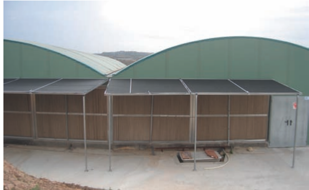
Sistema de refrigeración con paneles humidificadores o cooling
