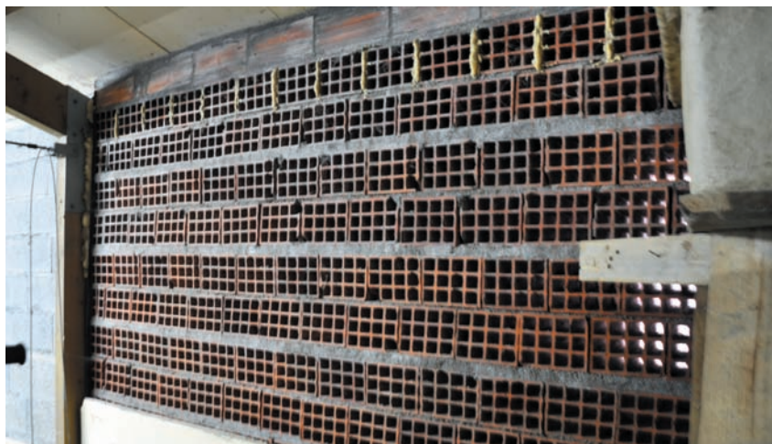
Granja Bosebo. Original, eficaz y económico sistema de refrigeración de la nave para verano.
