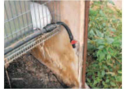
Todos los finales de tubería disponen de una llave de paso para vaciar rápidamente las tuberías y así poderlas limpiar en un breve periodo de tiempo.
