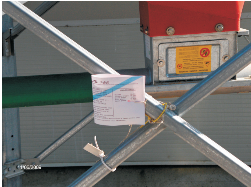
Correcta identificación del pienso que se encuentra en el silo.
