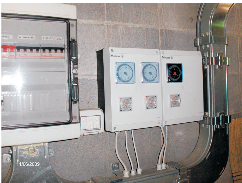
Centralita de control de la alimentación automática con los reguladores de tiempo para controlar la restricción del pienso a administrar.
