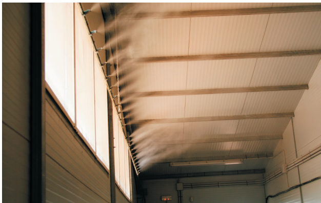
Un inadecuado mantenimiento o una mala calidad de los micropulverizadores puede hacer que las microgotas de agua generadas puedan ocasionar problemas respiratorios graves en los conejos.
