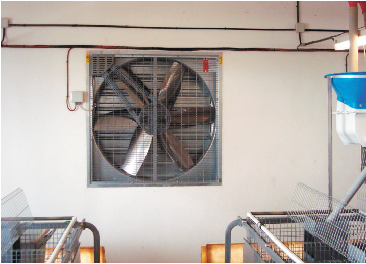
Para la ventilación longitudinal de la nave se usan extractores de gran caudal, entre 25.000 a 42.000 m 3 /hora.
